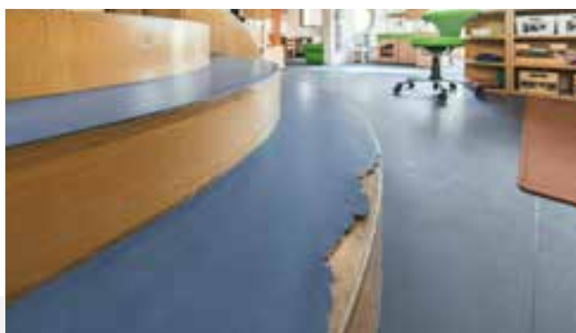
Avant : revêtement en linoléum usé présentant des éclats
