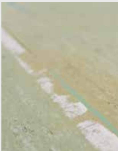
2 Réparation des défauts et épidémies
