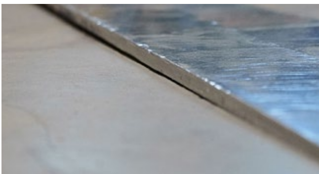
Vorher: Deformiertes Fugenprofil aus Metall.
