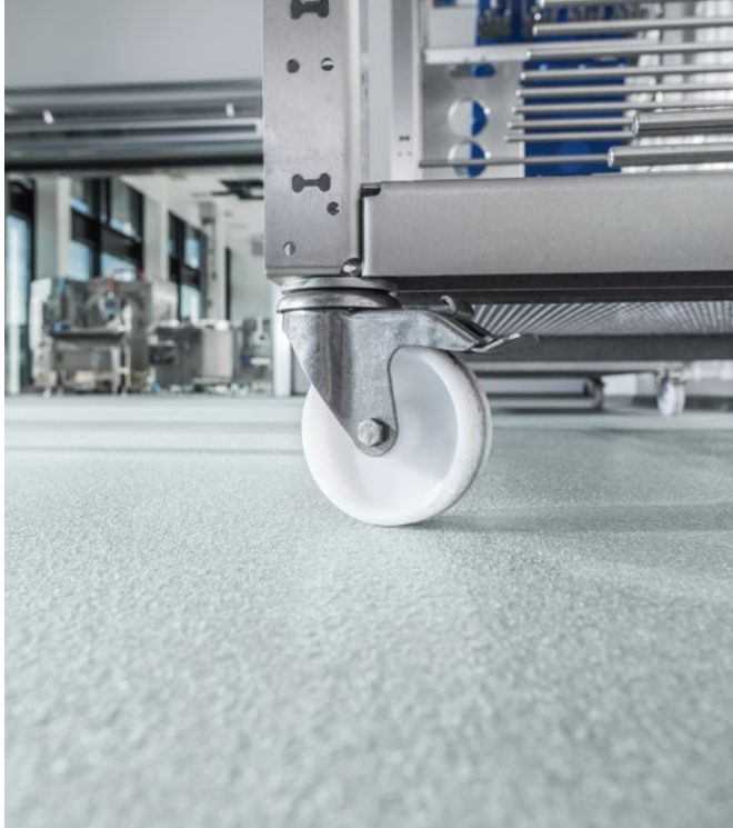
Rutschhemmende Einstellung durch Quarzsand-Abstreung.
