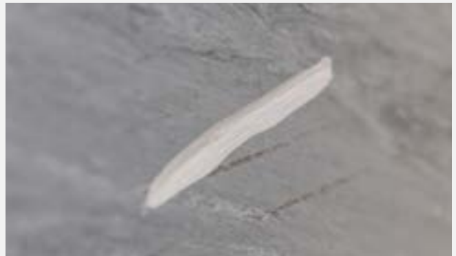
Ausbruch im elastischen Oberbelag
