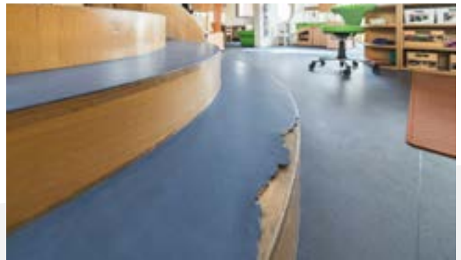
Vorher: Abgenutzter Linoleum-Belag mit Ausbrüchen
